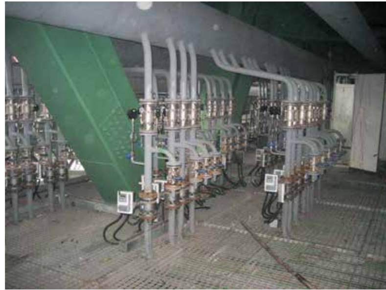
首钢京唐公司5500m 3 高炉软水小支管在线监测
