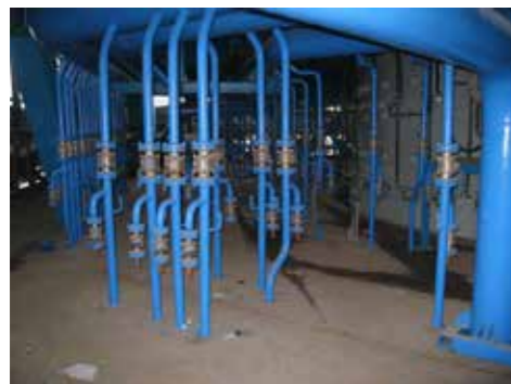
首钢迁钢3号4000m 3 高炉软水密闭循环冷却系统
